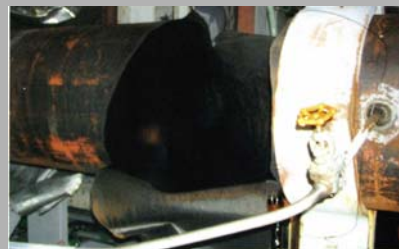
配管破損部の状況
