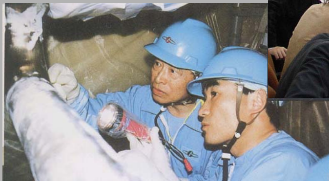
敦賀2号機1次冷却水漏えい事故立入調査 〔栗田知事（当時）と現場へ（平成11年）〕
